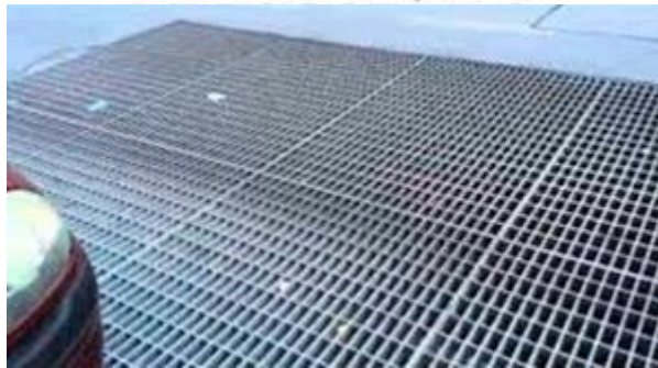
Figura 101. Rejilla de ventilación en superficie
