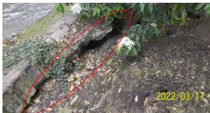
Figura 120. Box culvert estación Virrey costado oriental, pérdida del material de relleno
