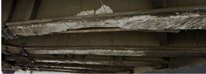
Figura 36. Puente vehicular (Autopista Norte sentido norte - sur), pérdida de recubrimiento en las vigas ubicadas en el costado sur del puente
