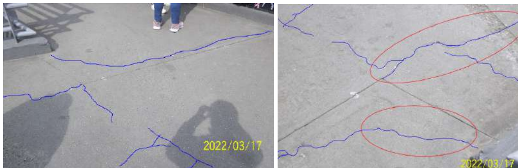
Figura 77. Puente peatonal Transmilenio calle 85, presencia de fisuras en las juntas de dilatación
