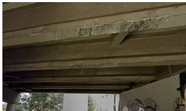
Figura 43. Puente vehicular (Autopista Norte sentido sur - norte), daños en las vigas ubicadas en el costado sur del puente, pérdida de recubrimiento
