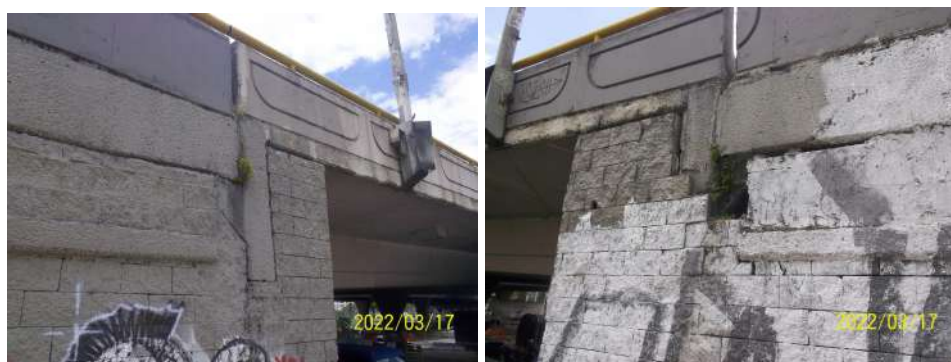
Figura 24. Puente vehicular Avenida calle 100 (Sentido oriente - occidente), presencia de material vegetal en ambos estribos
