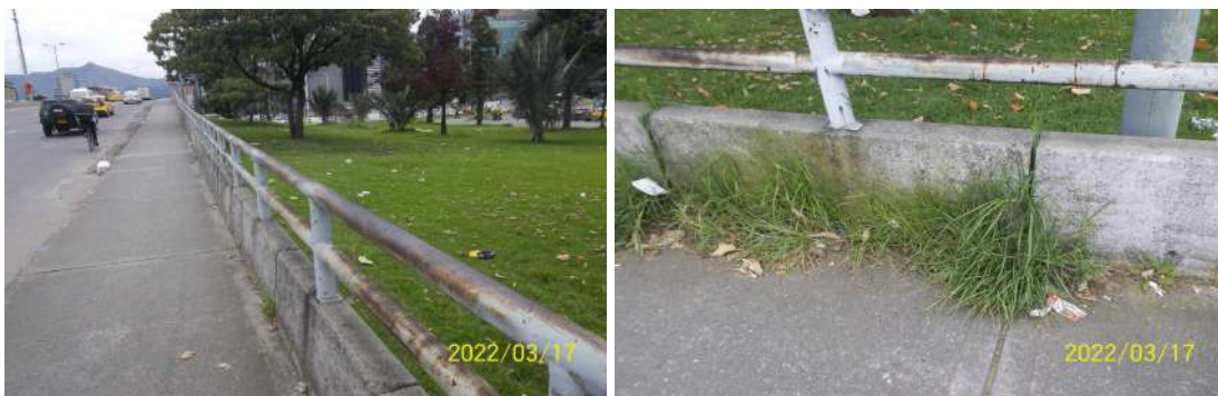
Figura 12. Puente vehicular Avenida calle 100 (Sentido occidente - oriente), presencia de material vegetal en el acceso peatonal y corrosión en la baranda peatonal
