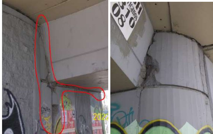
Figura 48. Puente vehicular (Avenida calle 92), grietas en el estribo ubicado en el lado sur del puente
