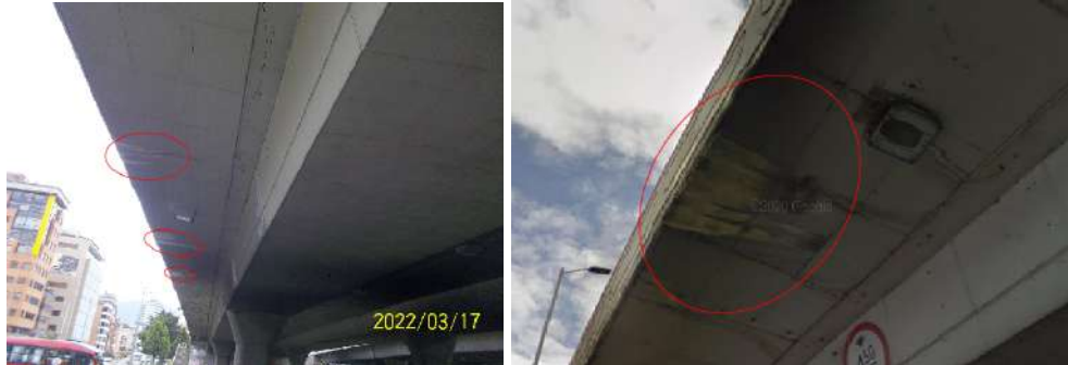
Figura 22. Puente vehicular Avenida calle 100 (Sentido oriente - occidente), presencia de eflorescencias en el tablero del puente
