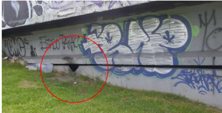
Figura 42. Puente vehicular (Autopista Norte sentido sur - norte), pérdida de material en la estructura de aproximación en el costado norte del puente
