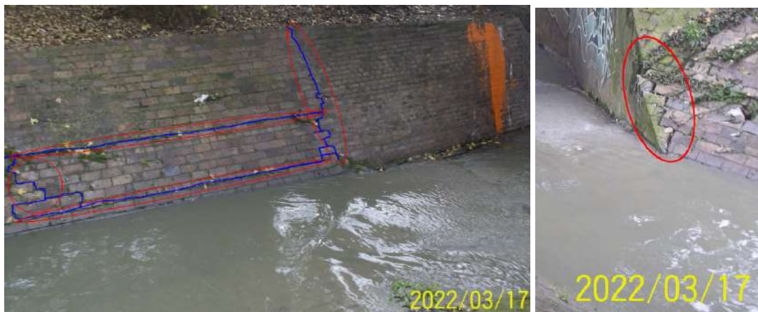
Figura 111. Box culvert estación Virrey costado oriental, presencia de grietas en las paredes del canal
