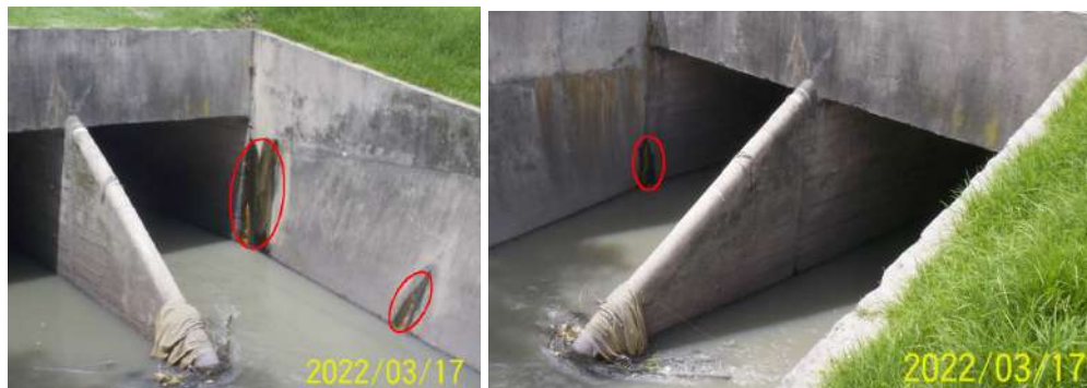
Figura 109. Box culvert estación Virrey costado occidental, presencia de eflorescencias cerca al cabezal del canal
