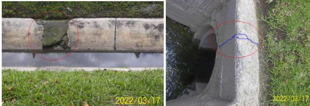
Figura 92. Canal calle 103B costado occidental, grietas en el cabezal del canal
