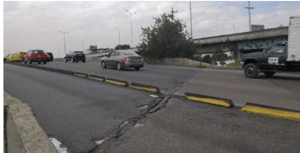
Figura 31. Puente vehicular (Autopista Norte sentido norte - sur), presencia de fisuras en la junta de dilatación en el costado norte del puente
