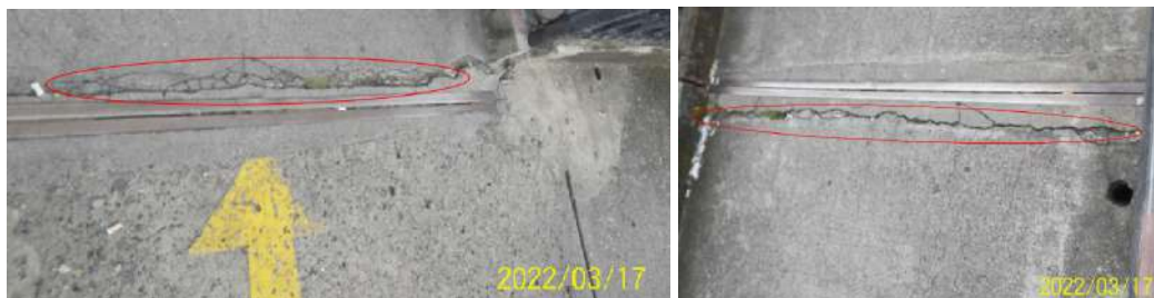
Figura 82. Puente peatonal Transmilenio estación Héroes, presencia de fisuras en las juntas de dilatación ubicadas a lo largo del puente
