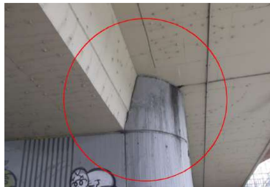
Figura 47. Puente vehicular (Avenida calle 92), grietas en el estribo ubicado en el lado norte del puente
