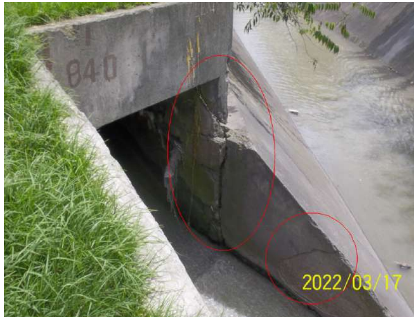
Figura 110. Box culvert estación Virrey costado occidental, presencia de grietas en el cabezal del canal
