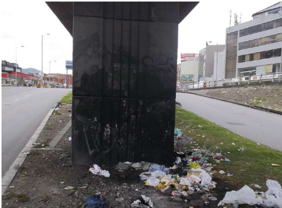
Figura 71. Puente Vehicular Héroes costado sur, daños en el pilar por fuego ubicado en el costado norte del puente
