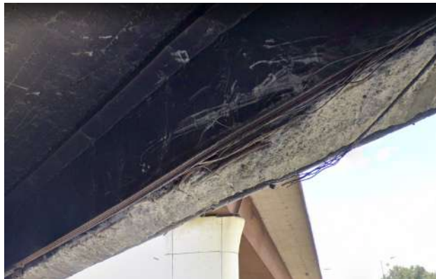
Figura 37. Puente vehicular (Autopista Norte sentido norte - sur), pérdida de recubrimiento en las vigas ubicadas en el costado sur del puente
