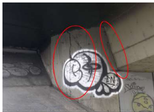
Figura 44. Puente vehicular (Avenida calle 92), grietas en el estribo ubicado en el lado norte del puente
