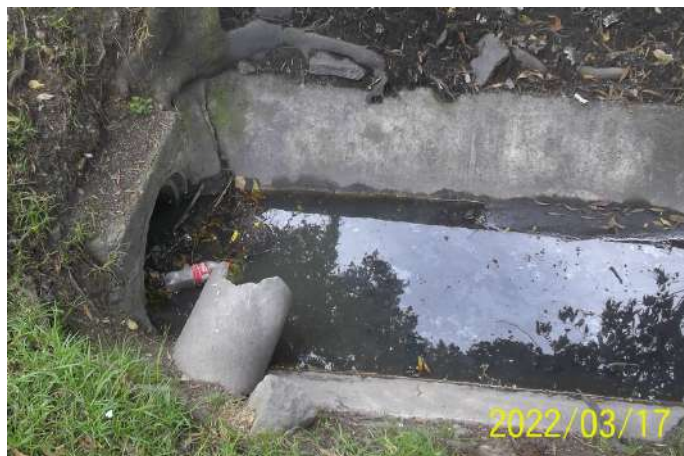
Figura 88. Canal calle 105 costado occidental, obstrucción por material vegetal y basura en los cabezales del puente
