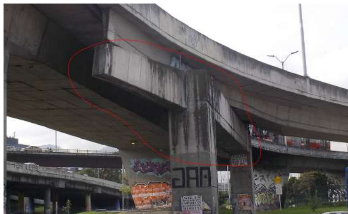
Figura 61. Puente vehicular (calle 89a), presencia de material vegetal y contaminación del concreto en la pila del puente
