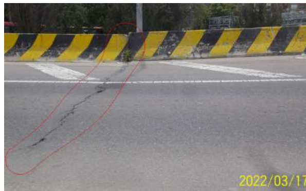
Figura 69. Puente Vehicular retorno a la diagonal 92, fisuras en la superficie de rodadura
