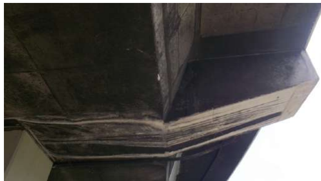
Figura 63. Puente Vehicular retorno a la diagonal 92, Presencia de eflorescencias y daños por fuego en el pilar, viga - cajón y el tablero del puente.
