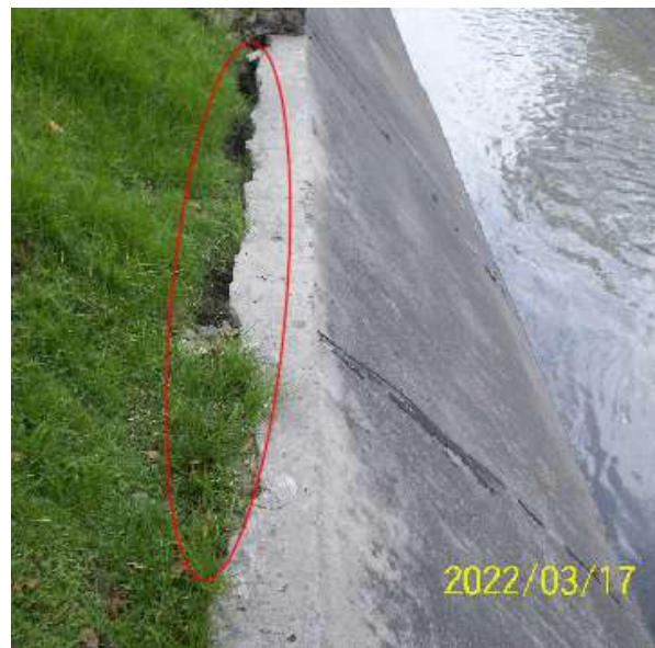
Figura 107. Box culvert estación Virrey costado occidental, pérdida de material de relleno
