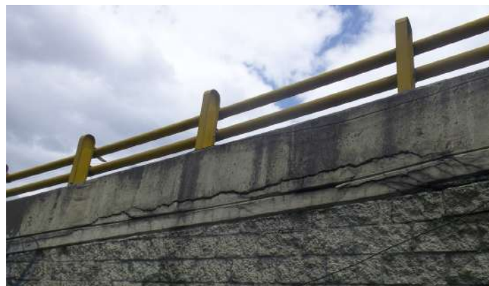
Figura 58. Puente vehicular metálico (Avenida carrera 30), fisuras en la estructura de aproximación en el costado sur del puente
