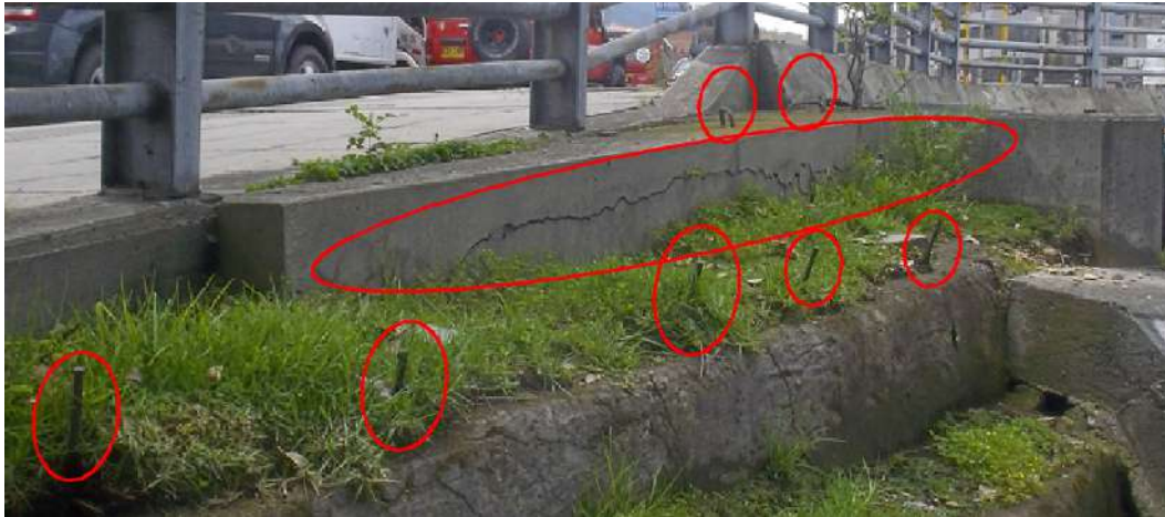
Figura 127. Deprimido/Estructura soterrada calle 77, acero expuesto
