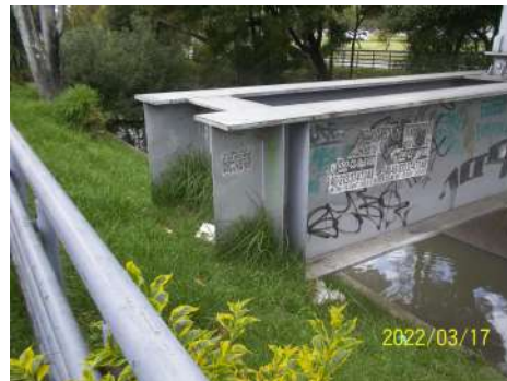
Figura 76. Puente peatonal calle 90 virrey transmilenio, presencia de material vegetal en los apoyos del puente
