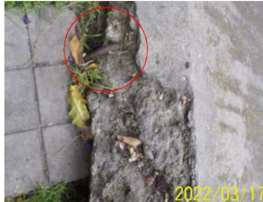
Figura 106. Box culvert estación Virrey costado occidental, acero expuesto y pérdida de material de relleno
