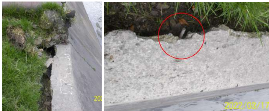
Figura 105. Box culvert estación Virrey costado occidental, acero expuesto y pérdida de material de relleno
