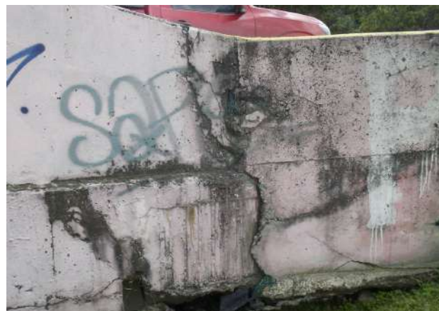
Figura 33. Puente vehicular (Autopista Norte sentido norte - sur), presencia de fisuras en la junta de dilatación y en
