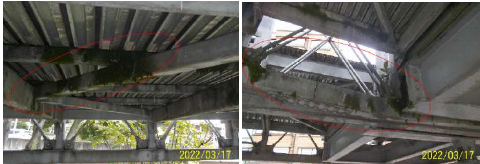
Figura 75. Puente peatonal calle 90 virrey transmilenio, presencia de material vegetal en los elementos del puente
