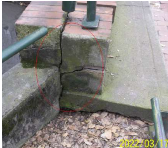
Figura 113. Box culvert estación Virrey costado oriental, presencia de grietas en la barrera peatonal del canal
