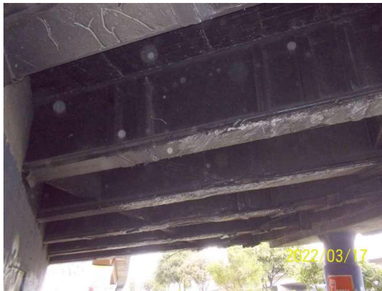
Figura 35. Puente vehicular (Autopista Norte sentido norte - sur), pérdida de recubrimiento en las vigas ubicadas en el costado sur del puente
