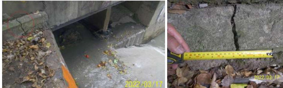
Figura 112. Box culvert estación Virrey costado oriental, presencia de grietas en el cabezal del canal
