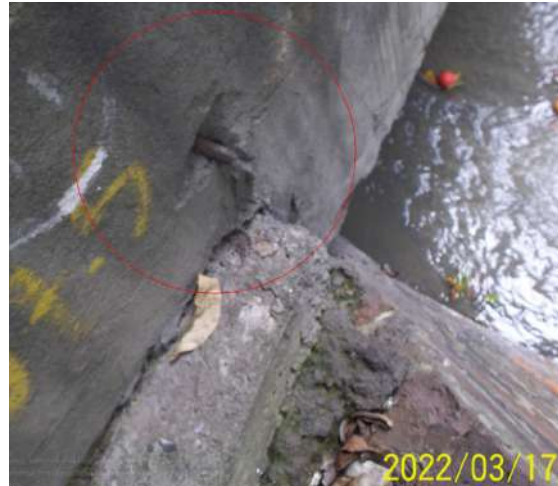
Figura 118. Box culvert estación Virrey costado oriental, acero expuesto
