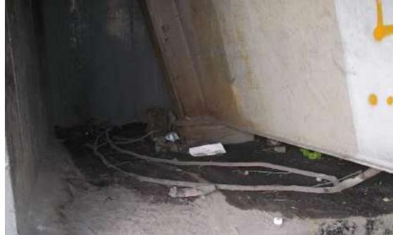
Figura 56. Puente vehicular metálico (Avenida carrera 30), presencia de material vegetal y basura en el estribo norte del puente
