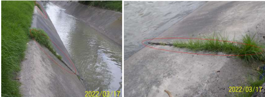
Figura 108. Box culvert estación Virrey costado occidental, desplazamiento de placas laterales del canal
