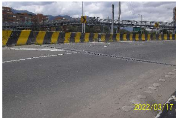
Figura 68. Puente Vehicular retorno a la diagonal 92, fisuras en la superficie de rodadura
