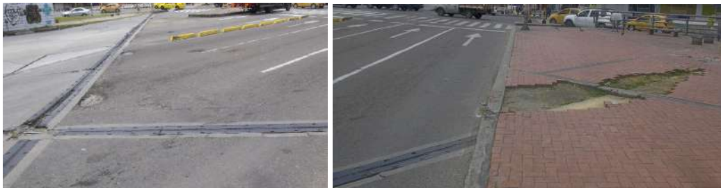
Figura 124. Deprimido/Estructura soterrada calle 77, presencia de grietas y daños en la zona cercana a las juntas de dilatación
