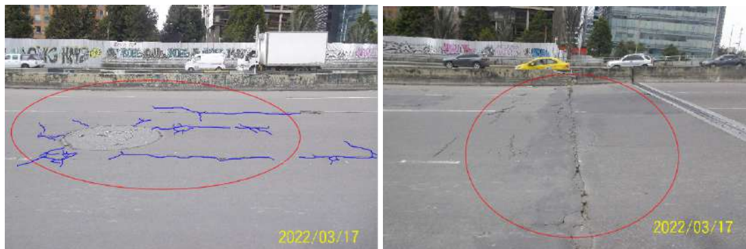
Figura 20. Puente vehicular Avenida calle 100 (Sentido oriente - occidente), presencia de fisuras en la capa de rodadura del puente
