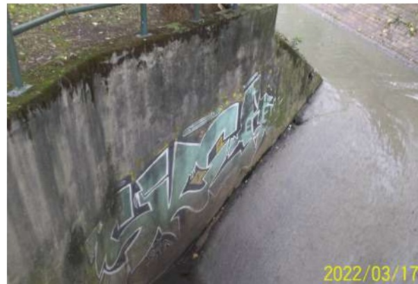
Figura 119. Box culvert estación Virrey costado oriental, presencia de material vegetal en las aletas del cabezal
