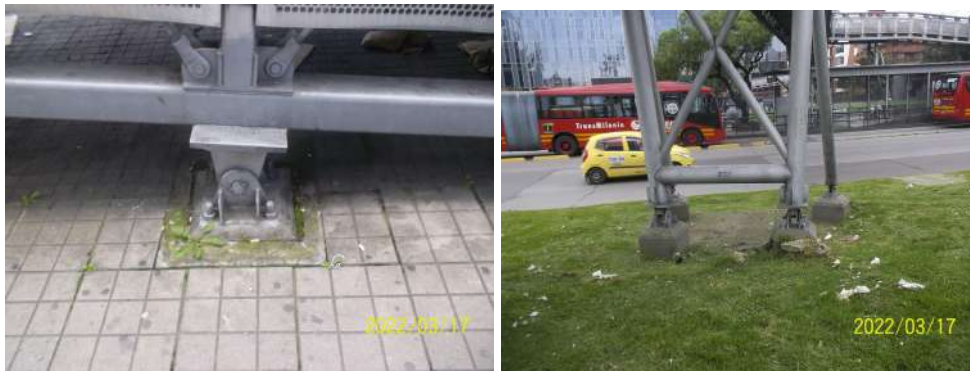
Figura 73. Puente peatonal calle 106 transmilenio, presencia de material vegetal y basura en los apoyos del puente
