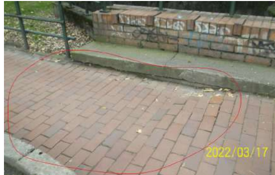
Figura 115. Box culvert estación Virrey costado oriental, posible asentamiento en el paso peatonal
