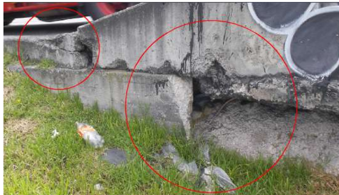
Figura 40. Puente vehicular (Autopista Norte sentido sur - norte), grietas en la barrera de tráfico y daños en la junta de dilatación del costado norte del puente
