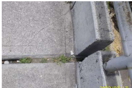
Figura 15. Puente vehicular Avenida calle 100 (Sentido occidente - oriente), presencia de material vegetal en las juntas de dilatación en el lado occidental y oriental del puente
