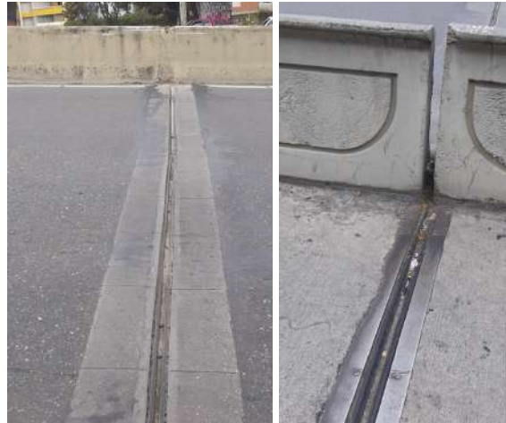
Figura 53. Puente vehicular (Avenida calle 92), junta de dilatación con presencia de suciedad y material vegetal
