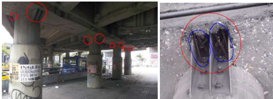
Figura 38. Puente vehicular (Autopista Norte sentido norte - sur), acero expuesto en las ménsulas de acero instaladas en los pilares ubicadas en el costado norte del puente
