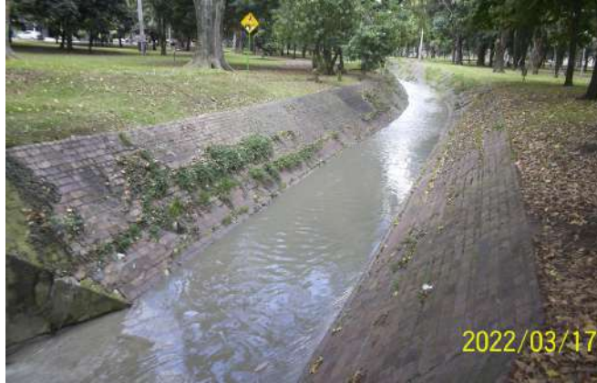
Figura 121. Box culvert estación Virrey costado oriental, presencia de material vegetal en las paredes del canal
