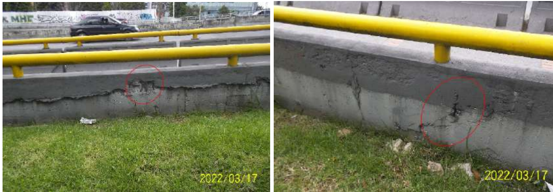
Figura 19. Puente vehicular Avenida calle 100 (Sentido oriente - occidente), acero expuesto en la barrera de tráfico
