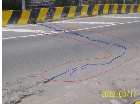
Figura 67. Puente Vehicular retorno a la diagonal 92, fisuras en la superficie de rodadura
