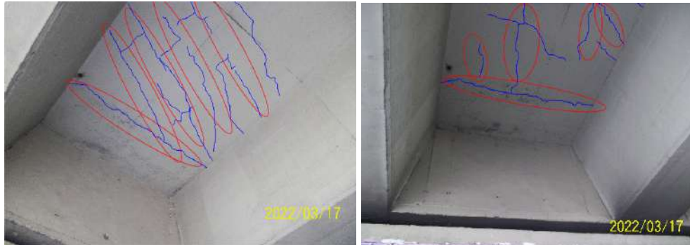
Figura 16. Puente vehicular Avenida calle 100 (Sentido occidente - oriente), presencia de fisuras en el tablero del puente, ubicadas en el extremo occidental de dicho puente
