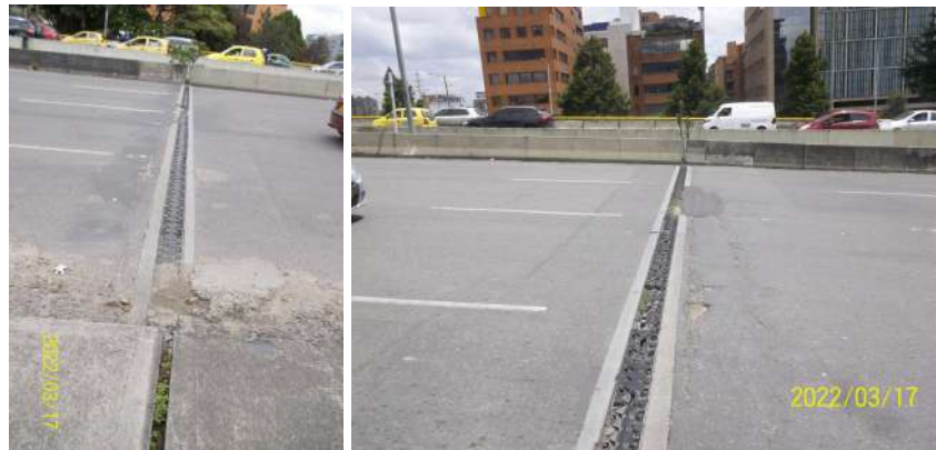
Figura 14. Puente vehicular Avenida calle 100 (Sentido occidente - oriente), presencia de fisuras y de material vegetal en las juntas de dilatación en el lado occidental y oriental del puente
