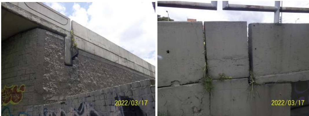
Figura 17. Puente vehicular Avenida calle 100 (Sentido occidente - oriente), presencia de material vegetal en ambos estribos del puente
