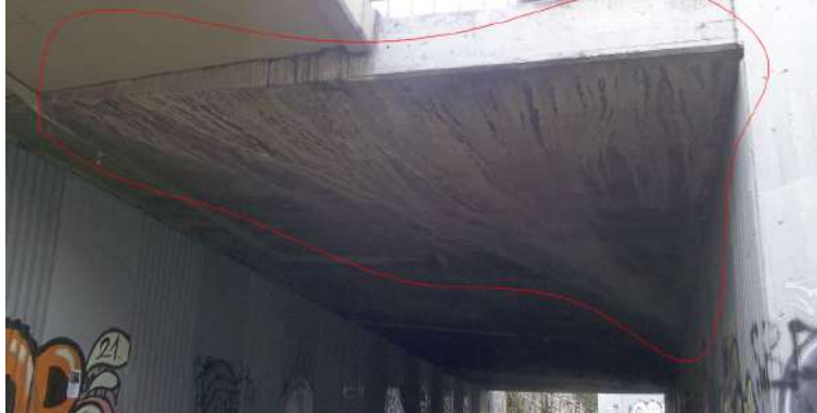
Figura 122. Box Coulvert peatonal, presencia de eflorescencias en la placa superior del Box Coulvert
