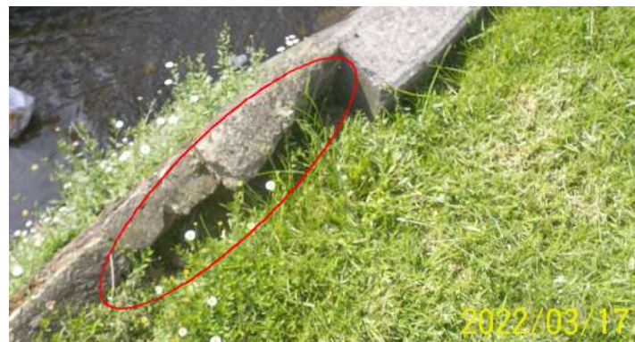
Figura 94. Canal calle 95 costado occidental, pérdida de material de relleno
