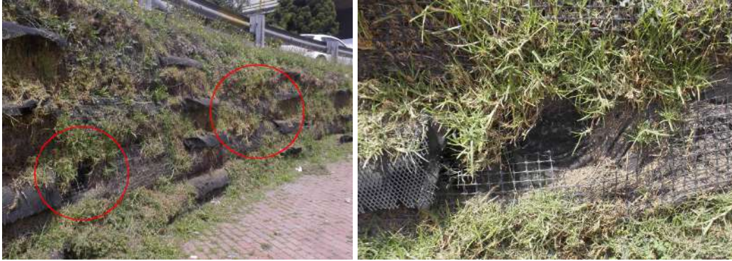
Figura 62. Puente Vehicular retorno a la diagonal 92, daños en el geotextil de la estructura de aproximación del puente, pérdida de material
