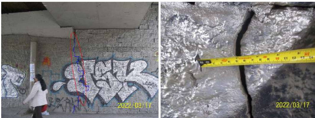
Figura 23. Puente vehicular Avenida calle 100 (Sentido oriente - occidente), presencia de grietas en el cerramiento en mampostería de la estructura de aproximación del costado occidental
