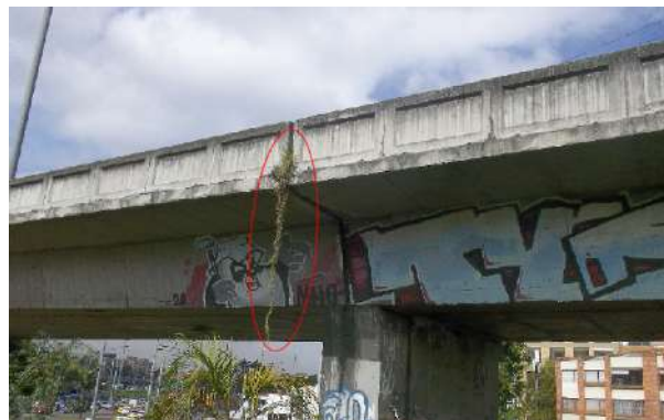
Figura 26. Puente vehicular (Calle 92), presencia de material vegetal en el tablero del puente
