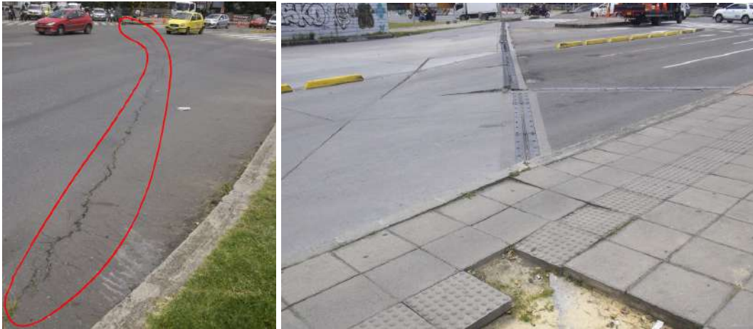
Figura 125. Deprimido/Estructura soterrada calle 77, presencia de grietas y daños en la zona cercana a las juntas de dilatación
