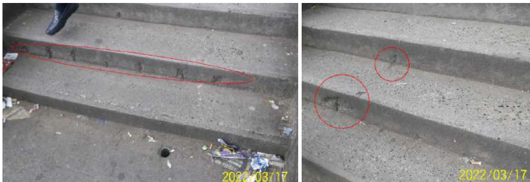
Figura 83. Puente peatonal Transmilenio estación Héroes, acero expuesto en los escalones del acceso peatonal del costado oriental
