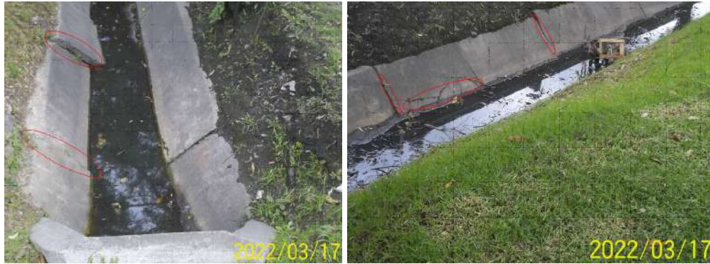
Figura 89. Canal calle 105 costado occidental, desplazamiento de las placas laterales del canal
