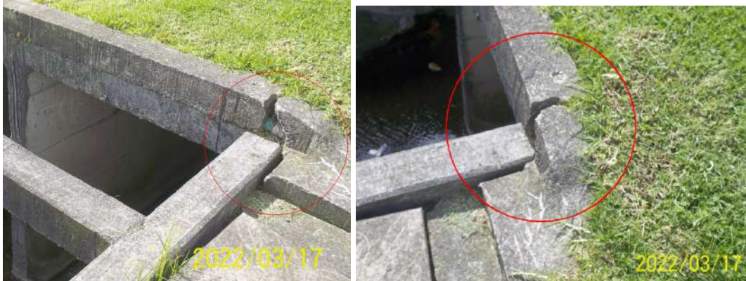
Figura 95. Canal calle 95 costado occidental, grietas en el cabezal del canal
