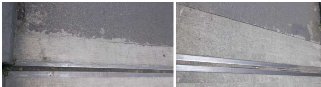
Figura 21. Puente vehicular Avenida calle 100 (Sentido oriente - occidente), presencia de basura en las juntas de dilatación
