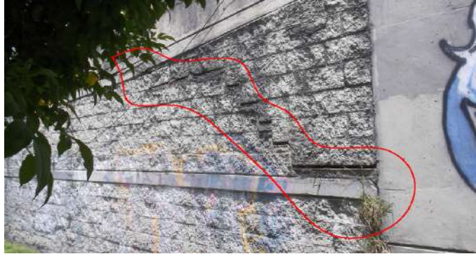
Figura 59. Puente vehicular metálico (Avenida carrera 30), daños en el cerramiento de la estructura de aproximación en el costado sur del puente
