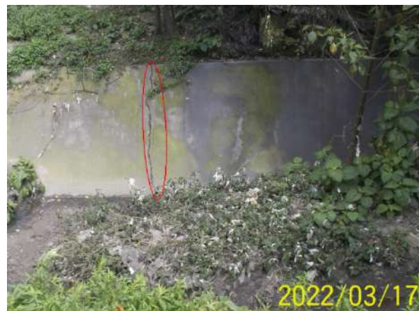
Figura 97. Box culvert estación Virrey costado occidental, fisuras en las placas laterales del canal
