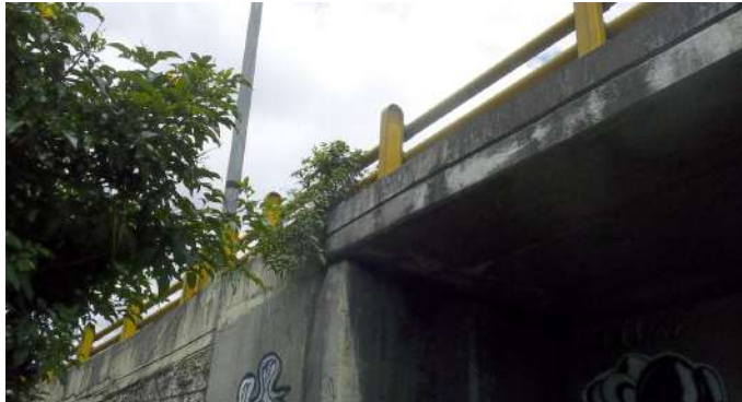
Figura 60. Puente vehicular metálico (Avenida carrera 30), presencia de material vegetal en ambos estribos del puente
