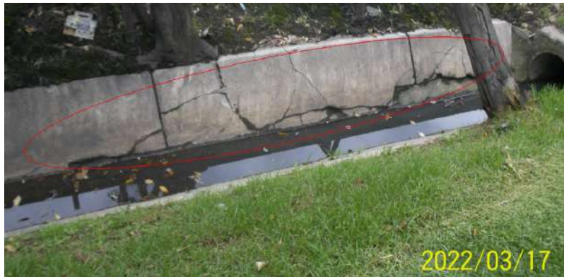
Figura 87. Canal calle 105 costado occidental, presencia de grietas en las placas laterales del canal
