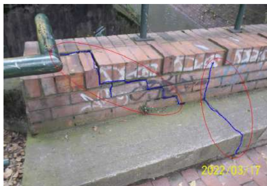
Figura 114. Box culvert estación Virrey costado oriental, presencia de fisuras y posible asentamiento en el paso peatonal
