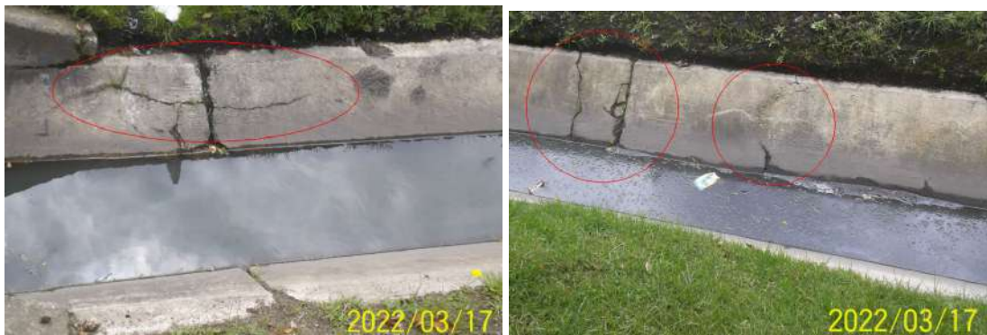
Figura 90. Canal calle 103B costado occidental, fisuras en las placas laterales del canal
