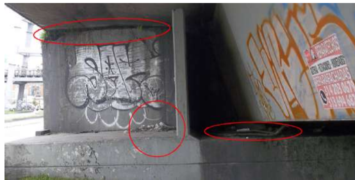
Figura 54. Puente vehicular metálico (Avenida carrera 30), presencia de material vegetal y basura en el estribo norte del puente
