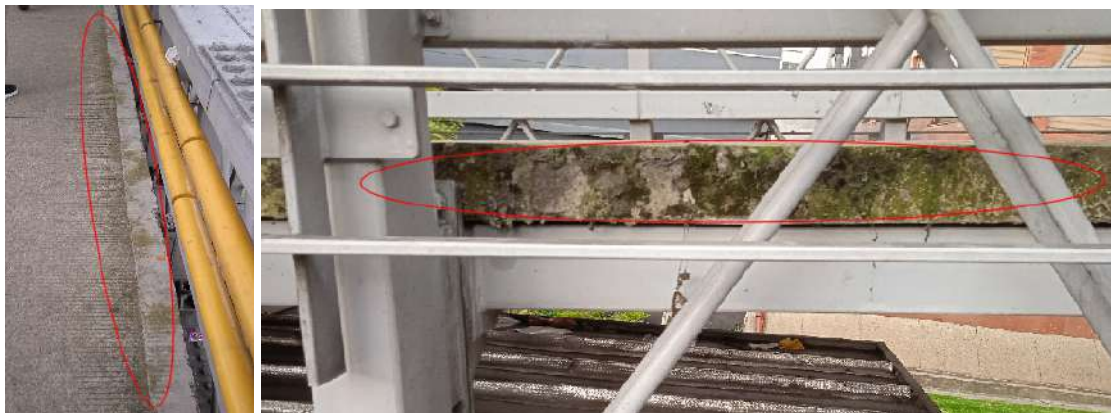
Figura 74. Puente peatonal calle 100 (lado sur) Transmilenio, presencia de material vegetal en el tablero del puente
