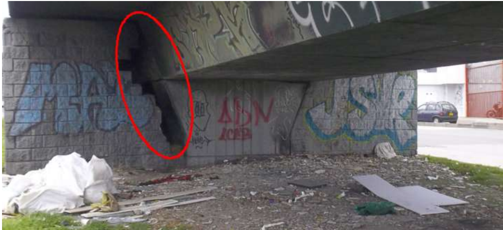
Figura 70. Puente Vehicular Héroes costado sur, pérdida de elementos de mampostería en el cerramiento de la estructura de aproximación ubicada al costado sur del puente
