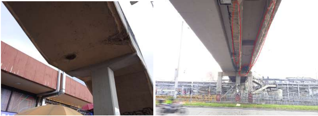
Figura 81. Puente peatonal Transmilenio estación Héroes, presencia de eflorescencias en la estructura de acceso y en las vigas del puente
