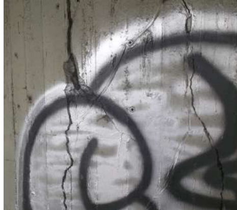
Figura 45. Puente vehicular (Avenida calle 92), grietas en el estribo ubicado en el lado norte del puente
