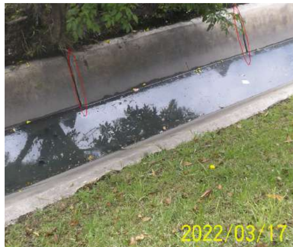
Figura 91. Canal calle 103B costado occidental, desplazamiento de las placas laterales del canal
