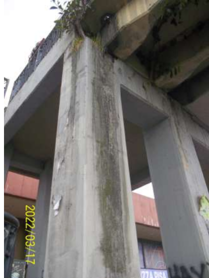
Figura 84. Puente peatonal Transmilenio estación Héroes, presencia de material vegetal en los pilares del puente
