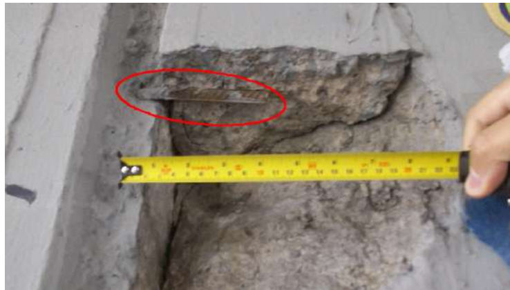
Figura 49. Puente vehicular (Avenida calle 92), grietas en el estribo ubicado en el lado sur del puente
