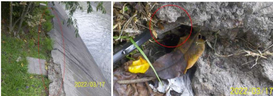
Figura 104. Box culvert estación Virrey costado occidental, acero expuesto y pérdida de material de relleno
