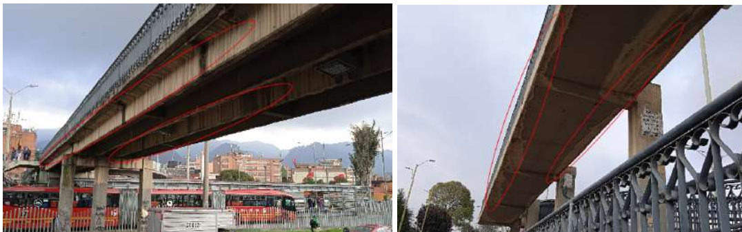
Figura 79. Puente peatonal Transmilenio estación Héroes, presencia de eflorescencias en el acceso peatonal, en las vigas y el tablero del puente
