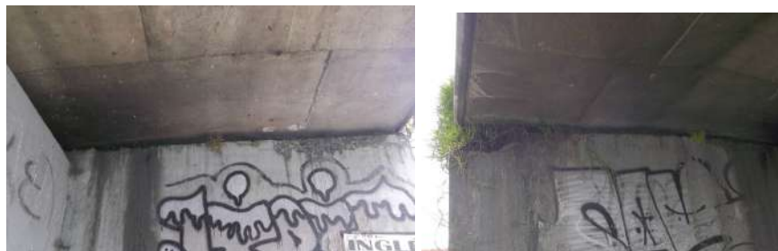
Figura 55. Puente vehicular metálico (Avenida carrera 30), presencia de material vegetal y basura en el estribo norte del puente
