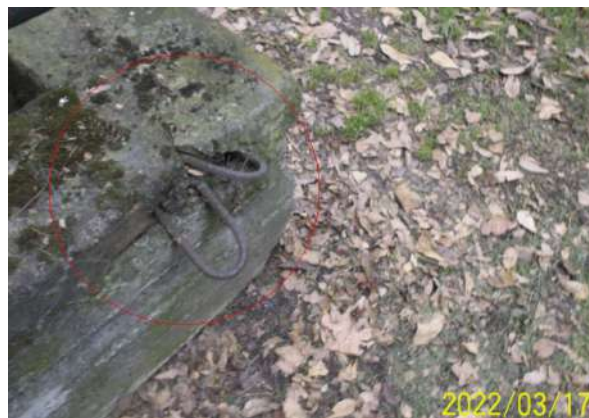
Figura 117. Box culvert estación Virrey costado oriental, acero expuesto
