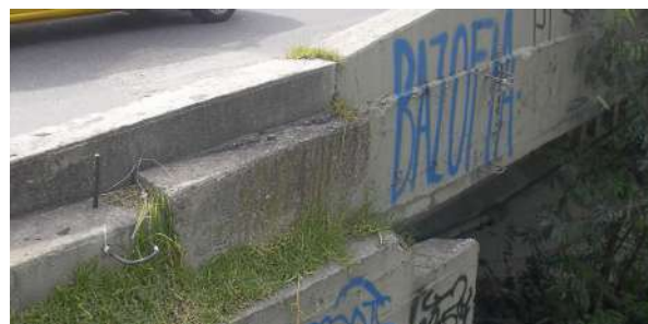
Figura 30. Puente vehicular (Autopista Norte sentido norte - sur), daños en el estribo y presencia de material vegetal en el costado norte del puente
