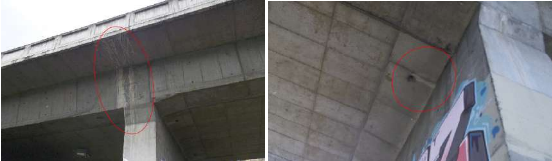
Figura 25. Puente vehicular (Calle 92), presencia de efflorescencias en el tablero del puente
