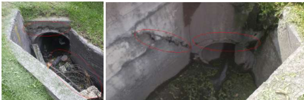
Figura 85. Canal calle 108 costado occidental, presencia de fisuras en los cabezales
