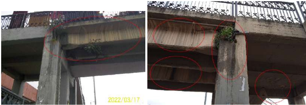
Figura 78. Puente peatonal Transmilenio estación Héroes, presencia de eflorescencias y material vegetal en vigas, tablero y columnas del puente
