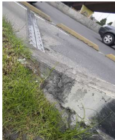
Figura 32. Puente vehicular (Autopista Norte sentido norte - sur), presencia de fisuras en la junta de dilatación y en la barrera de tráfico en el costado sur del puente
