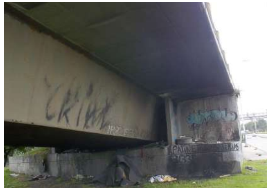
Figura 57. Puente vehicular metálico (Avenida carrera 30), presencia de material vegetal y basura en el estribo sur del puente
