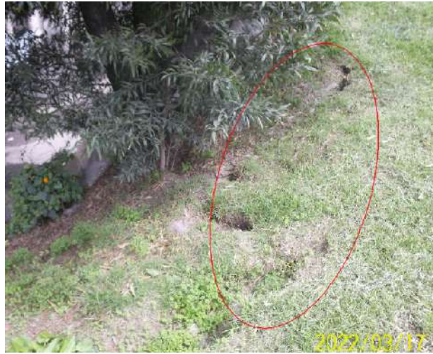
Figura 98. Box culvert estación Virrey costado occidental, posible erosión del talud
