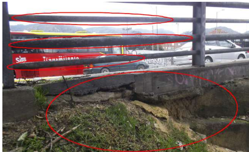
Figura 128. Deprimido/Estructura soterrada calle 77 - perdida de relleno en el acceso peatonal
