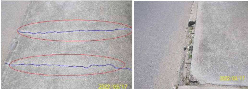
Figura 13. Puente vehicular Avenida calle 100 (Sentido occidente - oriente), fisuras en la placa del acceso peatonal y pérdida de recubrimiento en los andenes del acceso, costado occidental
