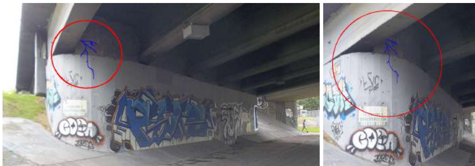
Figura 41. Puente vehicular (Autopista Norte sentido sur - norte), fisuras en el cerramiento de la estructura de aproximación en el costado norte del puente
