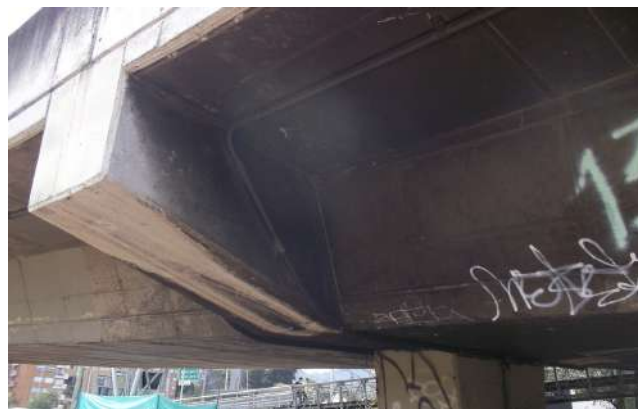
Figura 64. Puente Vehicular retorno a la diagonal 92, presencia de eflorescencias y daños por fuego en el pilar, viga - cajón y el tablero.
