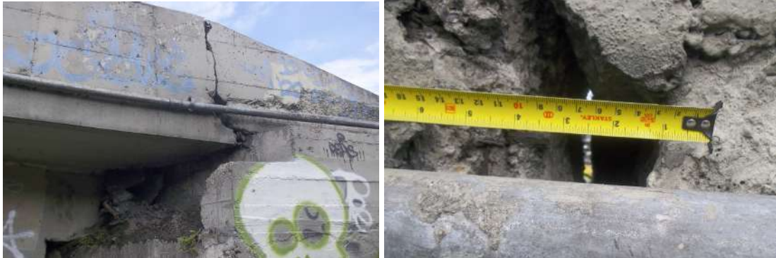
Figura 28. Puente vehicular (Autopista Norte sentido norte - sur), daños en el estribo y grietas la barrera de protección en el costado norte del puente
