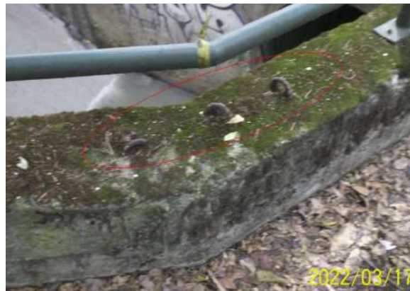
Figura 116. Box culvert estación Virrey costado oriental, acero expuesto
