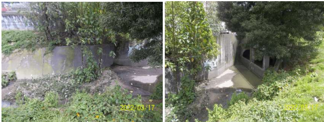
Figura 96. Box culvert estación Virrey costado occidental, presencia de material vegetal en la sección transversal del canal
