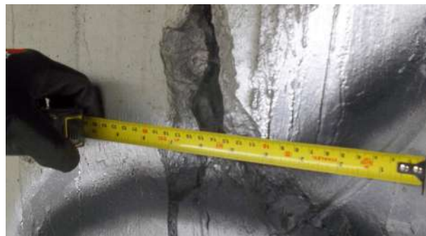
Figura 46. Puente vehicular (Avenida calle 92), grietas en el estribo ubicado en el lado norte del puente
