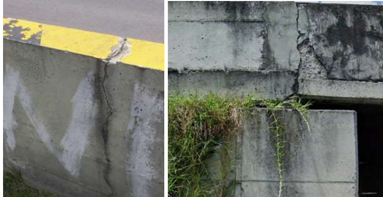
Figura 65. Puente Vehicular retorno diagonal 92, presencia de fisuras y material vegetal en ambos estribos del puente y en la barrera de protección
