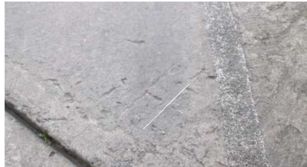
Figura 52. Puente vehicular (Avenida calle 92), acero expuesto en el acceso peatonal del costado norte del puente, en esta foto se evidencia la pérdida de recubrimiento de las barras de refuerzo de la placa del acceso peatonal
