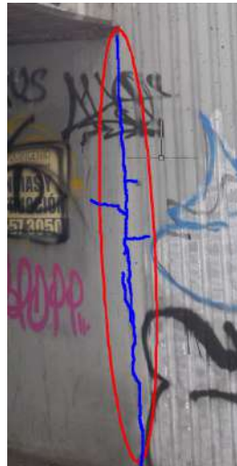
Figura 123. Box Coulvert peatonal, presencia de fisuras
