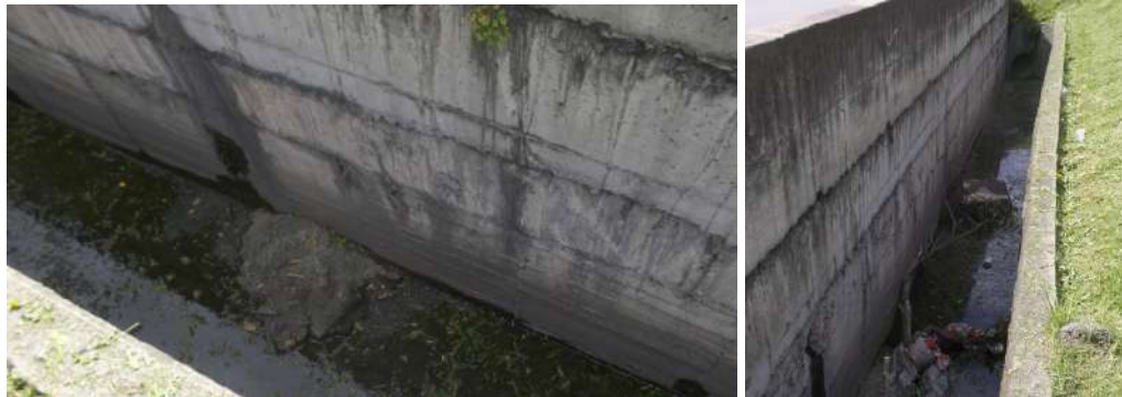
Figura 86. Canal calle 108 costado occidental, presencia de material vegetal y basura a lo largo del canal
