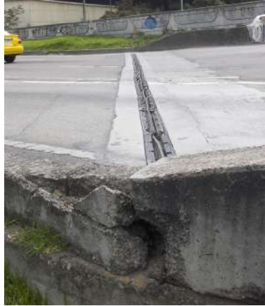
Figura 39. Puente vehicular (Autopista Norte sentido sur - norte), grietas en la barrera de tráfico y daños en la junta de dilatación del costado norte del puente
