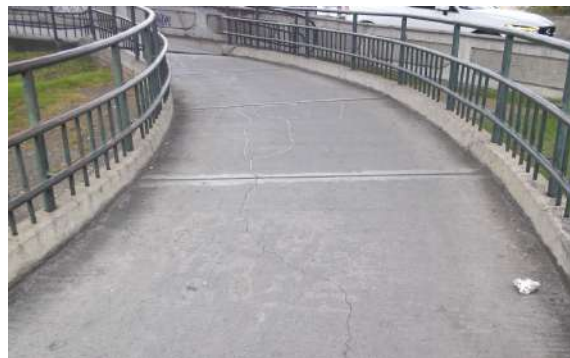
Figura 50. Puente vehicular (Avenida calle 92) - fisuras en el acceso peatonal costado norte del puente
