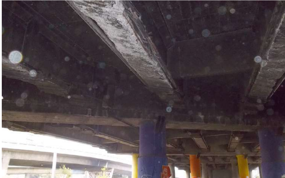
Figura 34. Puente vehicular (Autopista Norte sentido norte - sur), pérdida de recubrimiento en las vigas ubicadas en el costado sur del puente
