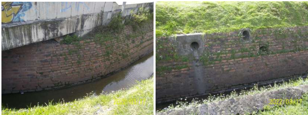
Figura 93. Canal calle 95 costado occidental, presencia de material vegetal en las paredes del canal
