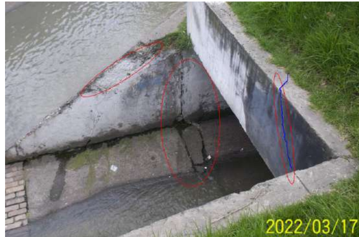
Figura 101. Box culvert estación Virrey costado occidental, fisuras en el cabezal del canal
