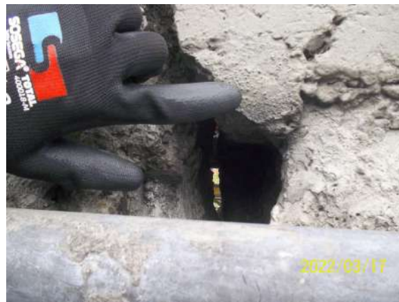
Figura 29. Puente vehicular (Autopista Norte sentido norte - sur), daños en el estribo y grietas en la barrera de protección en el costado norte del puente
