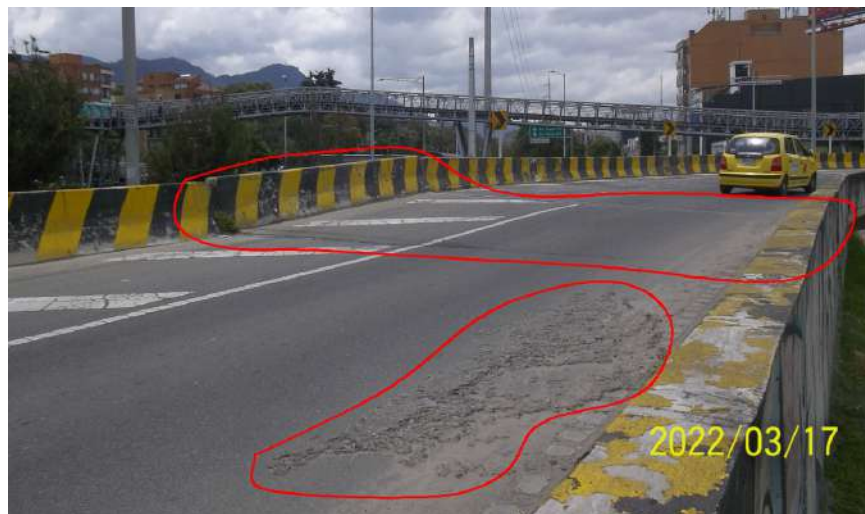
Figura 66. Puente Vehicular retorno a la diagonal 92, fisuras en la superficie de rodadura
