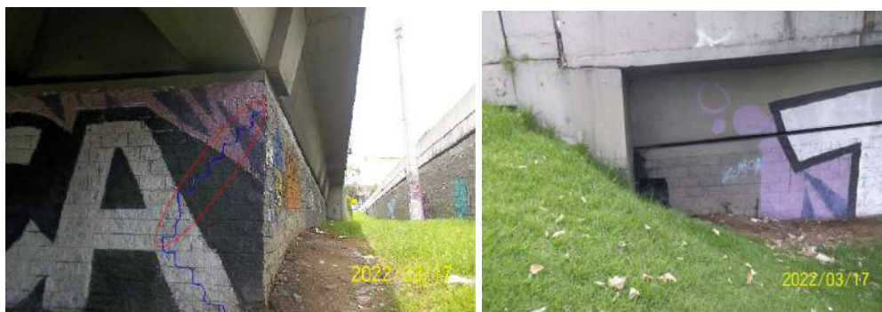
Figura 18. Puente vehicular Avenida calle 100 (Sentido occidente - oriente), grietas en el muro de cerramiento de la estructura de aproximación del puente y pérdida de elementos en dicho elemento
