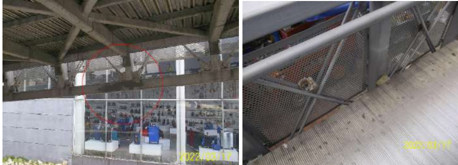
Figura 72. Puente peatonal calle 106 transmilenio, presencia de material vegetal y basura en los elementos del puente
