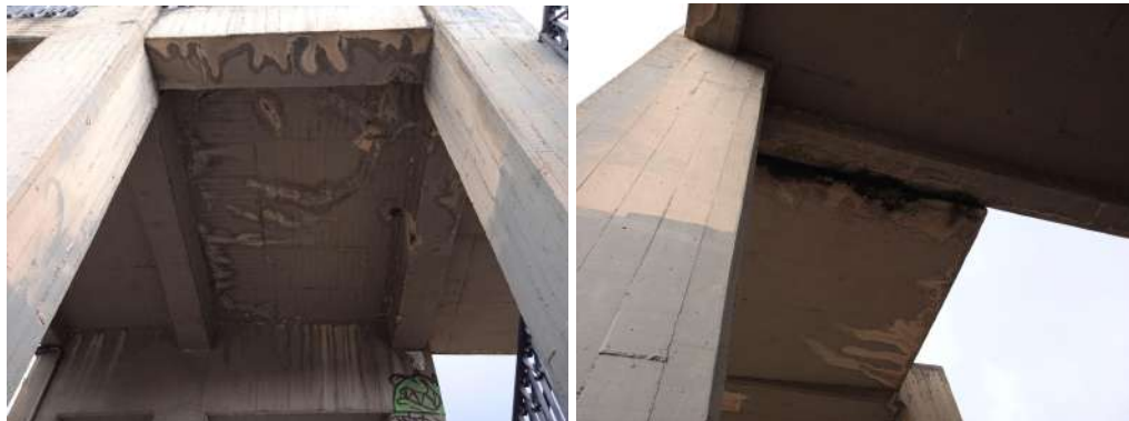
Figura 80. Puente peatonal Transmilenio estación Héroes, presencia de eflorescencias en la estructura de acceso del puente
