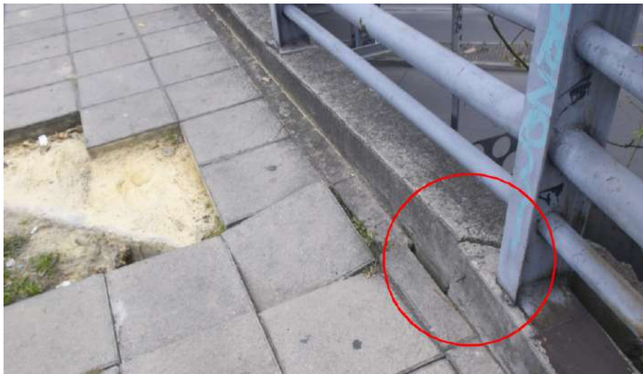
Figura 126. Deprimido/Estructura soterrada calle 77, presencia de grietas y daños en la zona cercana a las juntas de dilatación
