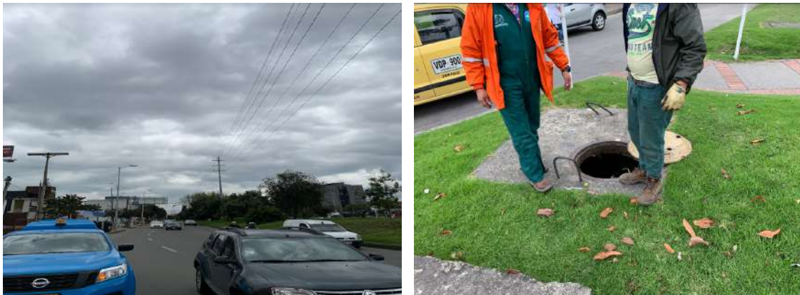
Fotografía 7. Válvula de Purga y Pozo Húmedo Línea Tibitoc K26+108
