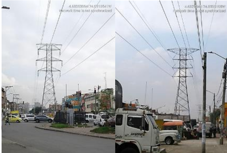
Fotografía 12. Red aérea de alta tensión - 115 kV - Av. Rojas Fuente: UT MOVIUS 2022
