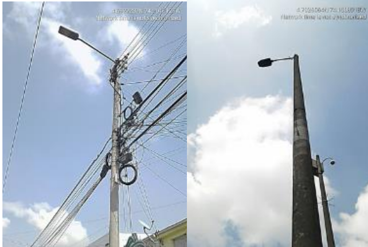
Fotografía 10. Redes aéreas de baja tensión 208/120V (Distribución - Alumbrado público) Fuente: UT MOVIUS 2022
