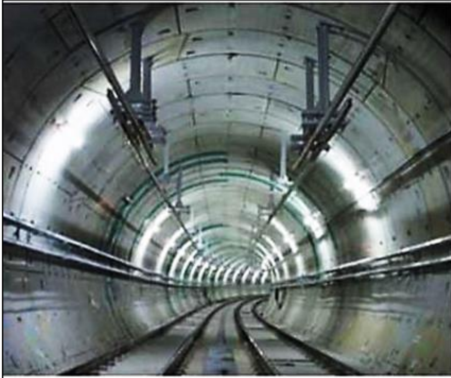
Figura 134. 1500 V con catenaria rígida en túnel Fuente: UT MOVIUS 2022
