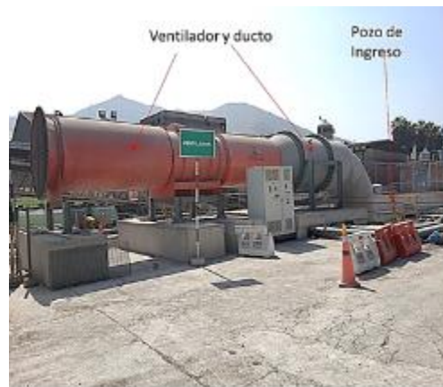
e. Ventilador y ducto
