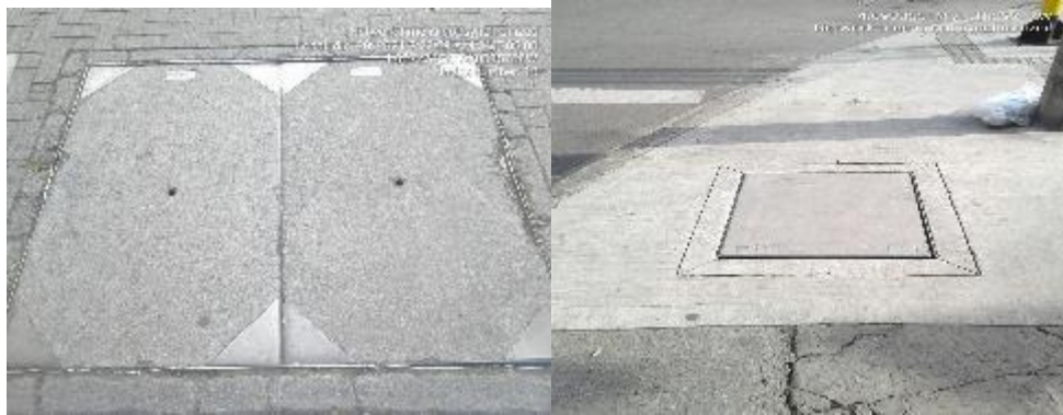
Fotografía 8. Cajas de inspección de redes subterráneas de energía MT 11,4 kV - BT 208/120 V - Canalizaciones Fuente: UT MOVIUS 2022
