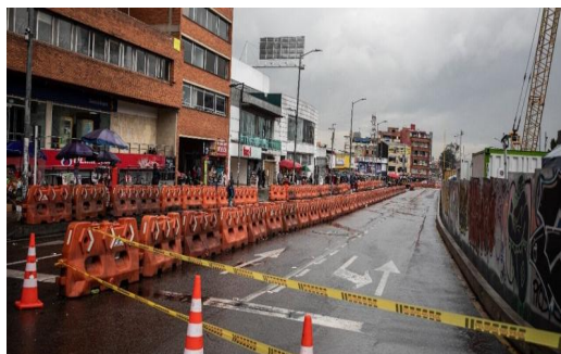
Fotografía 10. Cierre de la calle 72, entre carreras 13 y 15, realizado por el concesionario Metro Línea 1 (ML1), para facilitar la construcción del intercambiador vial en esa zona del norte de Bogotá. Fuente: Empresa Metro de Bogotá, 2022.
