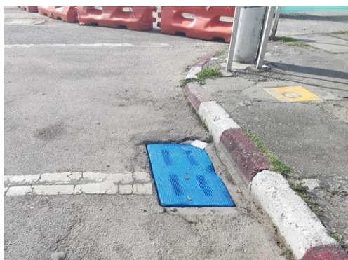
Figura 4 Protección de sumideros
