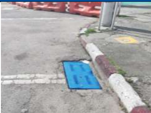
Figura 4 Protección de sumideros
