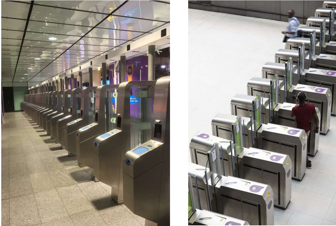
Figura 23. Líneas de control y validadores (torniquetes) del Metro de París
