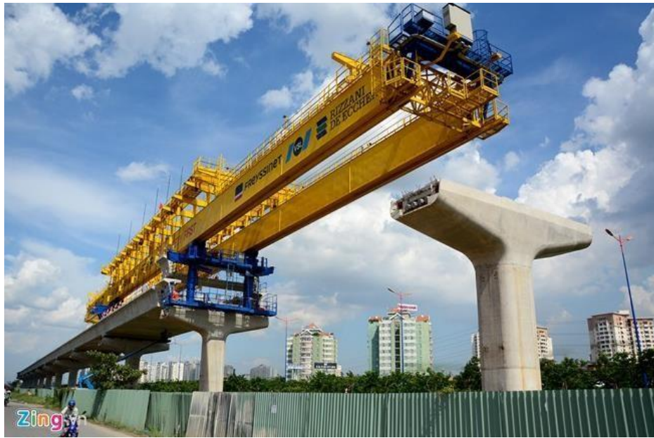
Ilustración 24 - Montaje del tablero gran U del metro de Ho Chi Minh mediante viga lanzadora
