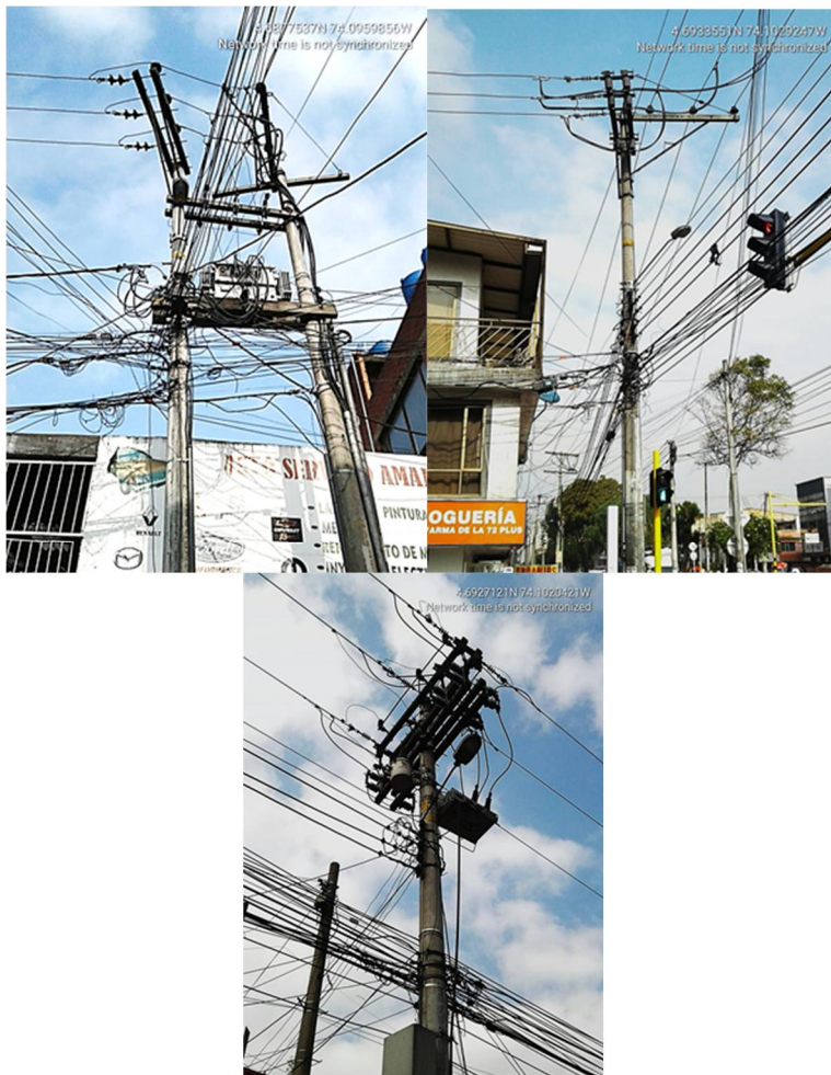
Fotografía 9. Redes aéreas de media tensión 11,4 kV (Transformador - Equipo de maniobra - Reconector) Fuente: UT MOVIOUS 2022
