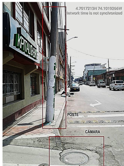
Fotografía 18. Redes de Tigo-Une sobre la estación Av. C. Cali. Fuente: UT MOVIUS 2022
