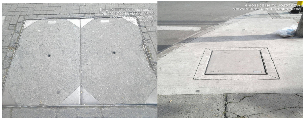
Fotografía 8. Cajas de inspección de redes subterráneas de energía MT 11,4 kV - BT 208/120 V - Canalizaciones
