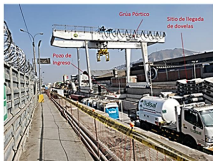
c. Puente grúa y zona de manipulación de dovelas
