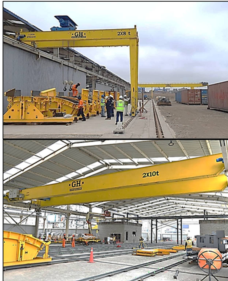
Fotografía 7. Tipo de equipos e instalaciones requeridos para la planta de dovelas (planta de dovelas línea 2 metro Sao Paulo actualmente en construcción)
