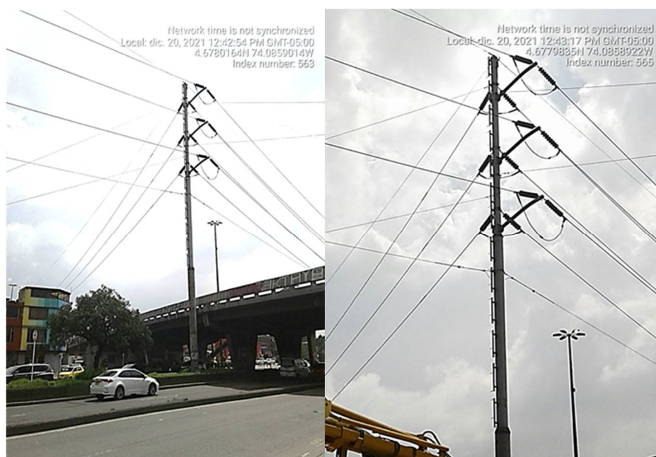
Fotografía 11. Red aérea de alta tensión - 115 kV - Av. 68 Fuente: UT MOVIUS 2022
