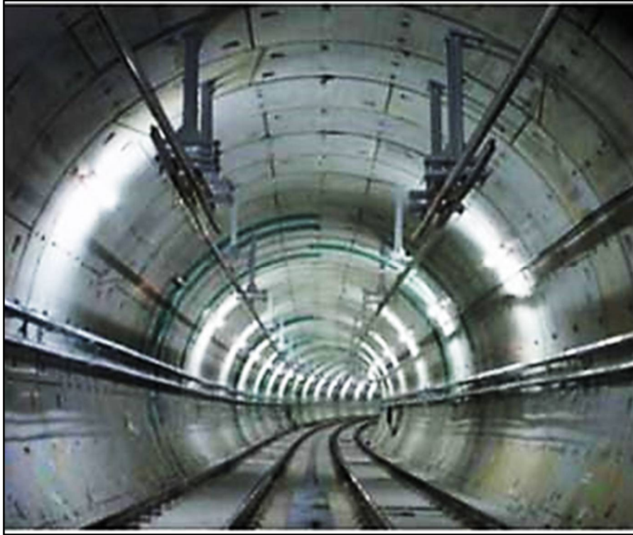
Figura 132. 1500 V con catenaria rígida en túnel Fuente: UT MOVIUS 2022
