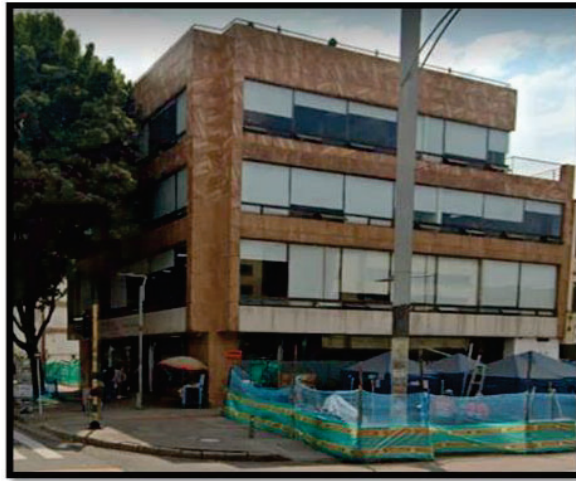
Fuente: Memorias de cálculo, 30/04/2023 -Anexo a la factura FE-32, radicado No. FACT23-0001935 Fotografía No. 2 Durante el proceso de demolición del predio AAA0094HXXX.
