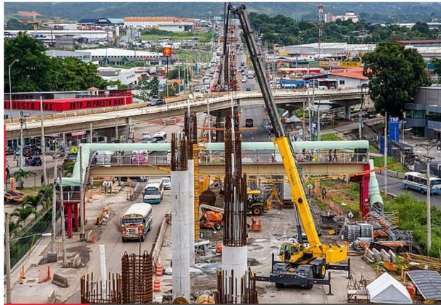
Fotografía 5. Avance en la construcción del viaducto. Línea 2 Metro de Ciudad de Panamá. https://elcapitalfinanciero.com/linea-2-del-metro-de-panama-registra-40-de-avance/
