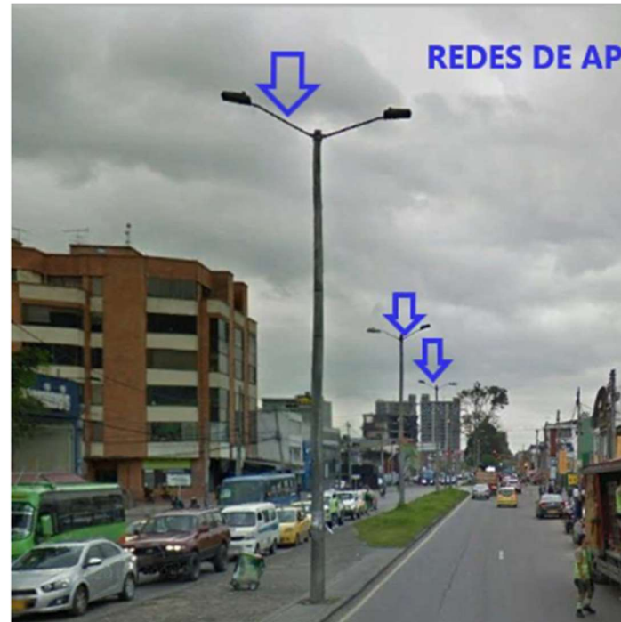
Figura 5.6 Red de Alumbrado Público Calle 72 – Av. Caracas
