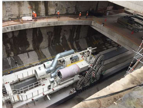
a. Sistema de ventilación
